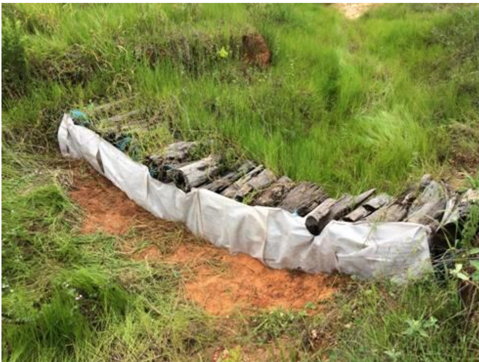
Paliçada restaurada com novas telas evidenciando o crescimento de capim no entorno.
